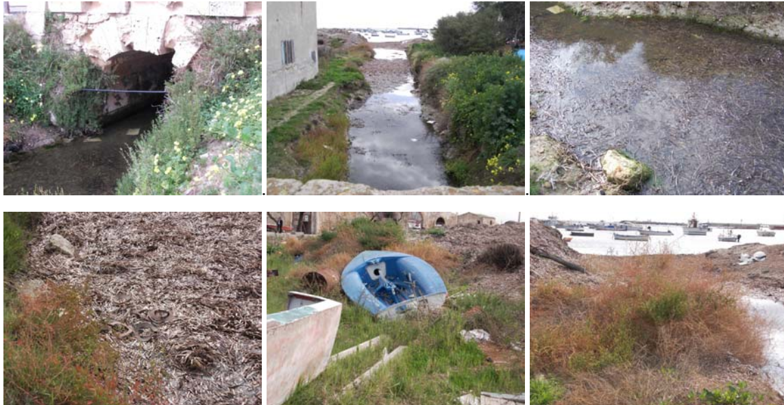
Fig. 8-13 Canale di scolo ostruito da foglie di Posidonia oceanica e sede di accumulo di rifiuti
